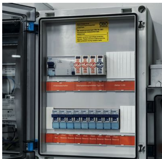
Bild 11: Im Verteiler eingebaute Überspannungsschutzeinrichtung Typ 2
