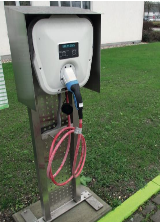
Bild 12: Ladestation im Außenbereich mit Regendach
