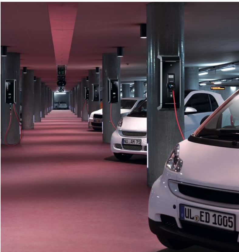
Bild 9: Ladeeinrichtungen für Elektrofahrzeuge in einer Tiefgarage
