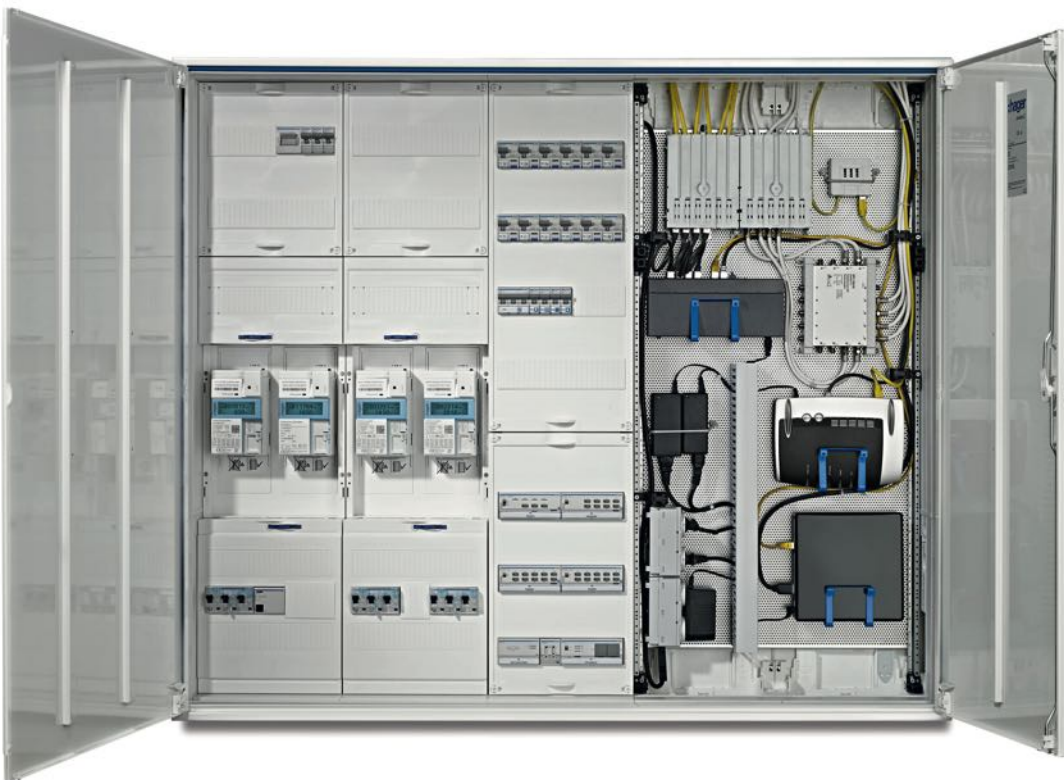
Bild 8: Moderner Zähler-schrank mit elektronischen Haushaltszählern, u. a. für PV-Anlage, Wärmepumpe oder Elektrofahrzeug
